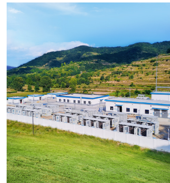
清水黄门 100MW 农光储一体化电站
