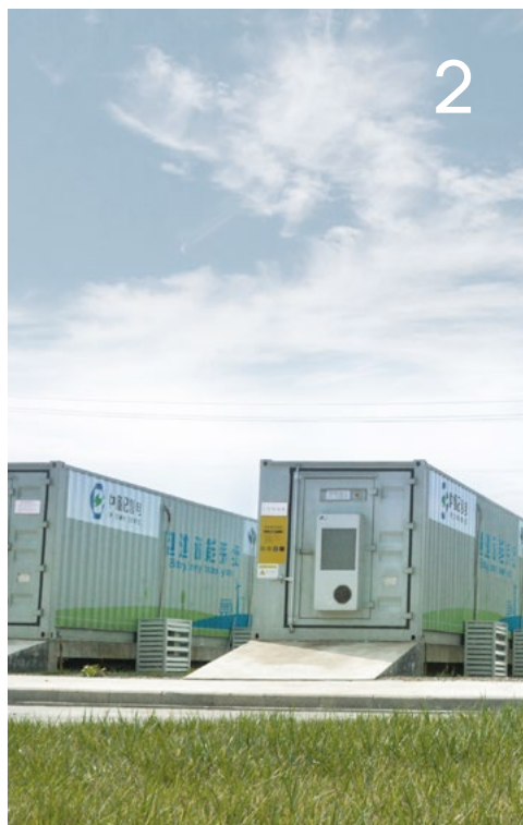
2 峰谷套利 5MW/10MWh 南京用户侧示范项目 江苏·南京
