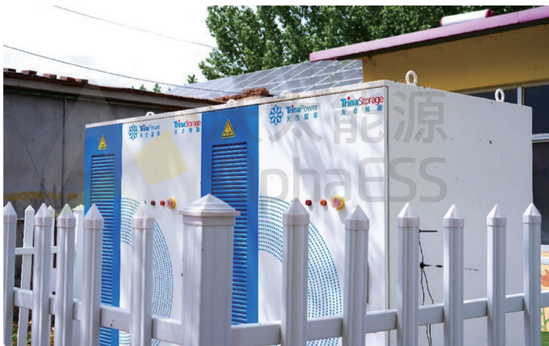
图 25 天合光能华东某地区台区储能项目
